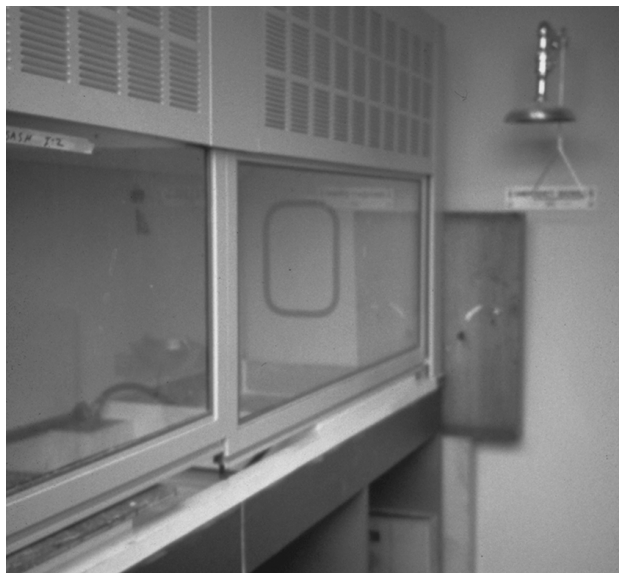
Figura 94.2 • Campanas de extracción de humos y ducha de emergencia en un laboratorio de ciencias de un centro de enseñanza secundaria.
